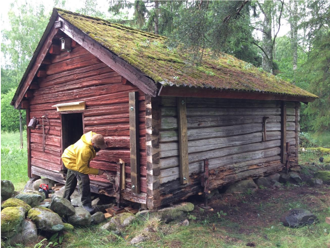
Här ska timmer bytas på en ekonomibygnad med laxade knutar, vilket är samma som huset för rådgivningen.
