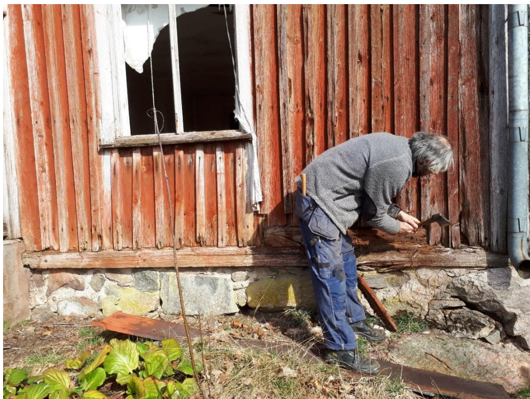
Syllen är täckt med en offerbräda på A-vägg som skyddar den riktiga syllen som ligger bakom. Syllen är i bra skick på denna vägg.
