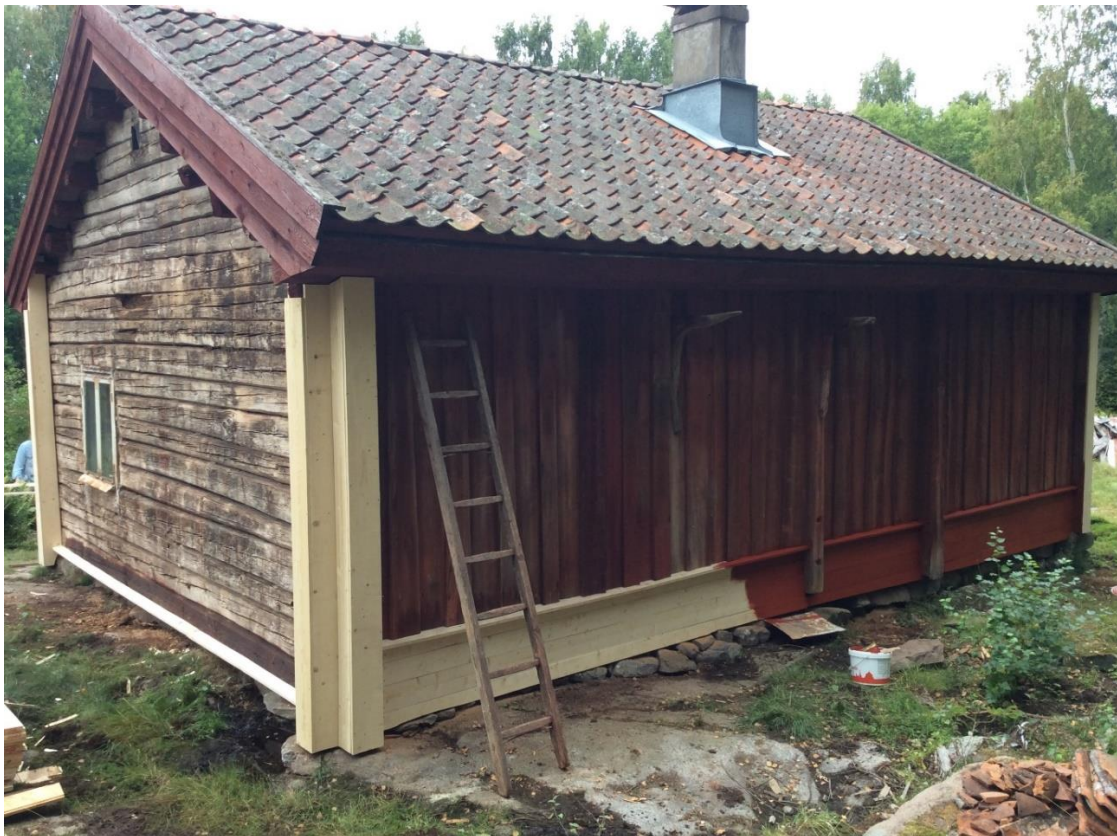
Drognos lägger under den gamla panelen och under lägger man liiggande brädor. Detta gör man för att slippa byta hela panelen om den endast är dålig nertill.
