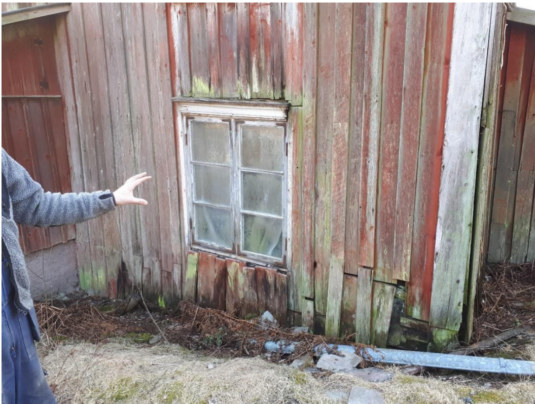
Här finns behov av att få avrinningen att bli bättre så att vattnet rinner ifrån huset och inte under, speciellt det vattnet som kommer från sluttningen. Köket ligger innanför väggen.
