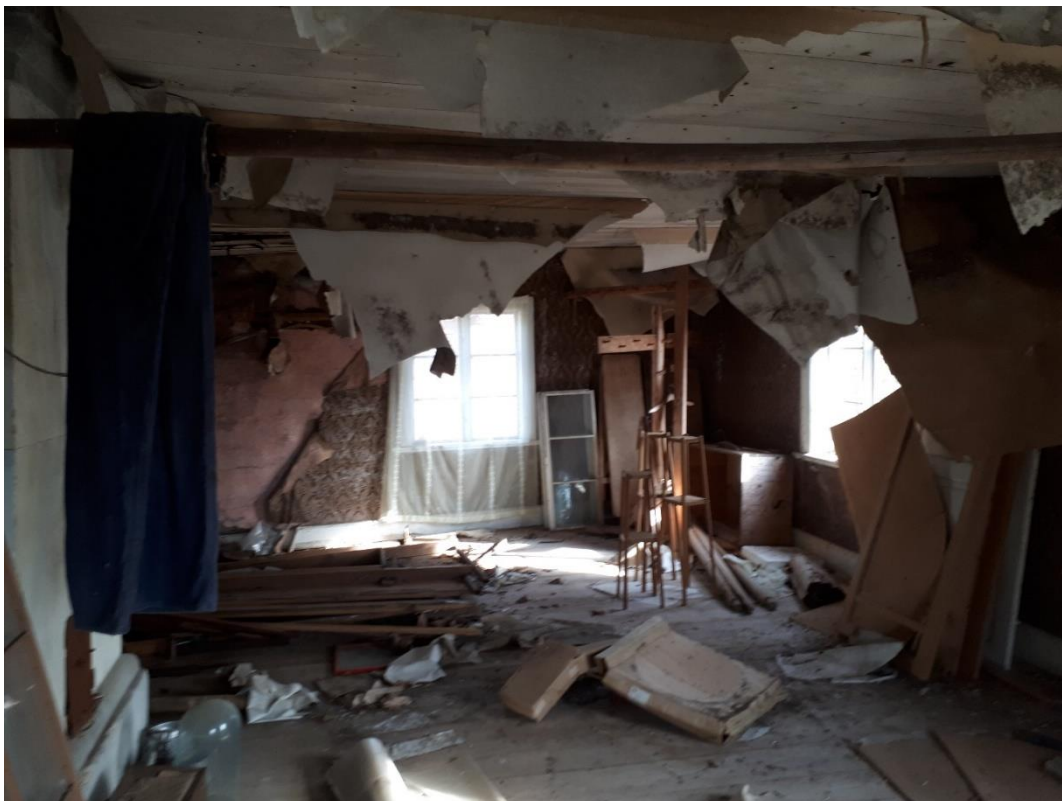
Foto taget på andra våning (C vägg rakt fram och D V ägg till höger)
