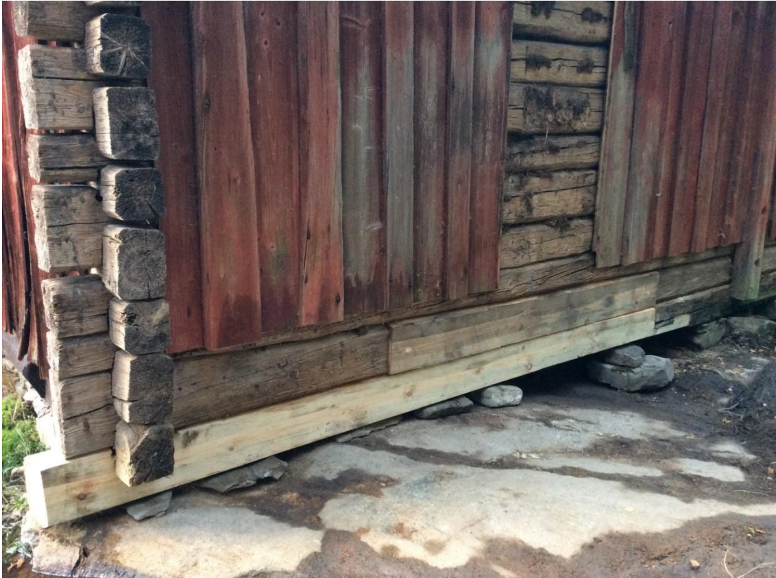
Hakskarv i syllen (längst ner) och byte av timmer genom halvt i halvt på andra timmerraden. Panelen var dålig nertill och därför sågades den av med en vinkel på 15 grader.
